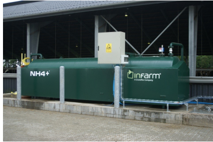
Foto 1. Forsøringsanlæg på kvægejendom (Foto: Torkild S. Birkmose, Agro Tech)
